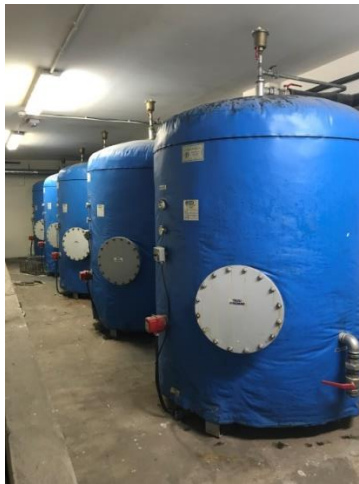
Image 17: Photographie des ballons d'eau chaude - Source: SPL Energies Réunion
