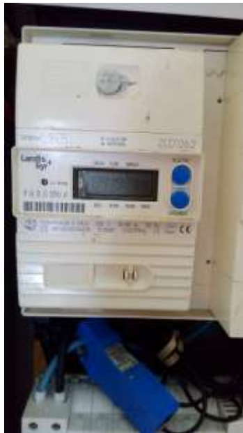
Image 8 : UX120-006M et pince ampèremétrique sur compteur - Source: oer
