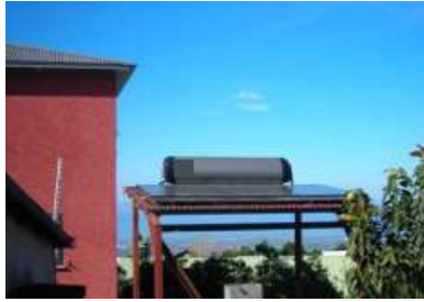
Photo 4: Représentation d'un chauffe-eau solaire posé sur annexe (Source : EDF/ARTELIA)
