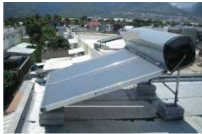
Photo 3: Représentation d'un chauffe-eau solaire posé sur toiture terrasse (Source : EDF/ARTELIA)
